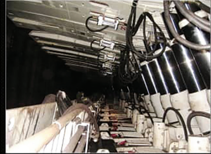
جک های قدم زن هیدرولیک جهت نگهداری سقف
